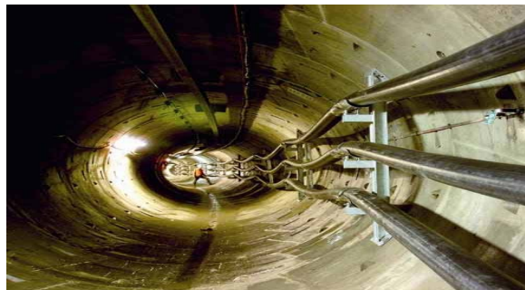
Gambar 1.8 Saluran Transmisi Bawa Tanah
