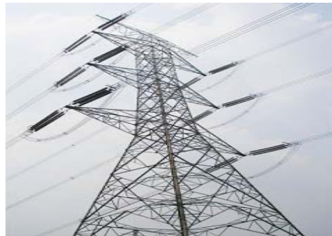
Gambar 1.7 Tiang Transmisi Tenaga Listrik
