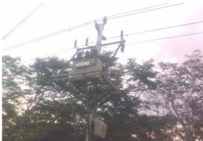
Gambar 6.8 Trafo Distribusi Satu Fasa
